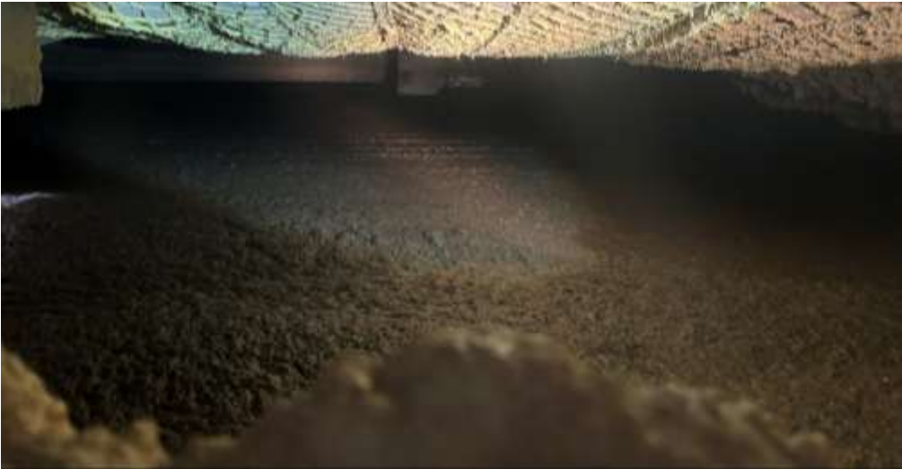
Photo de l'intérieur d'un digesteur
