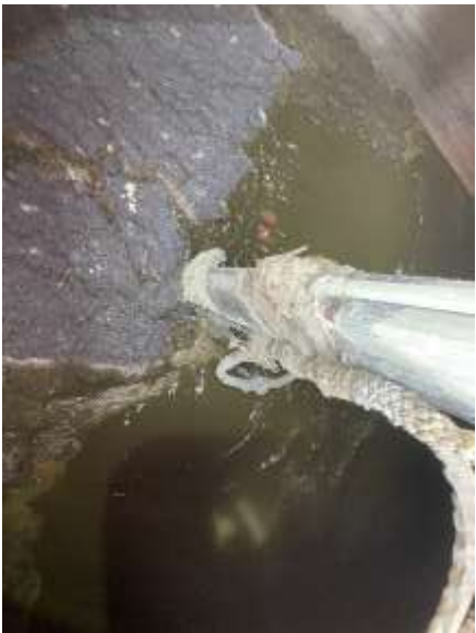
Photo d'une fosse à lisier
