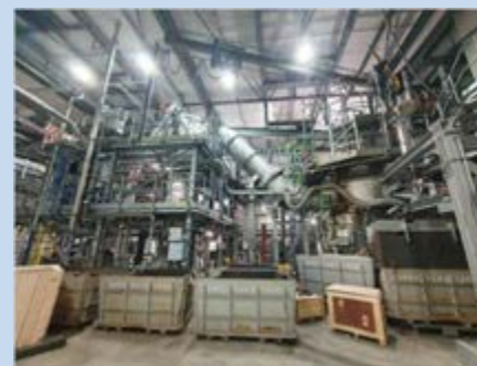
Installation ABSL Swindon : pyrogazéification à gauche, méthanation à droite
