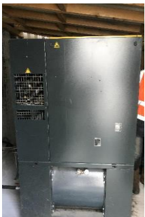
Compresseur d'air 11 kW
