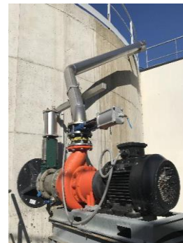
Pompe recirculation: moteur de 18,5 kW
